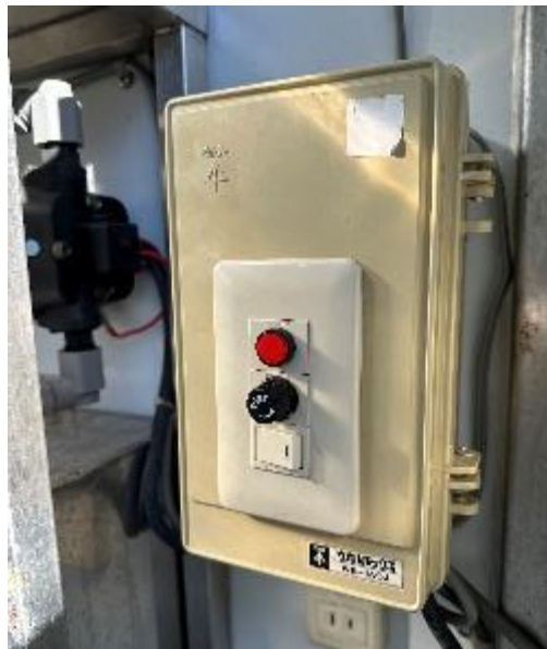
分電盤ボックス
